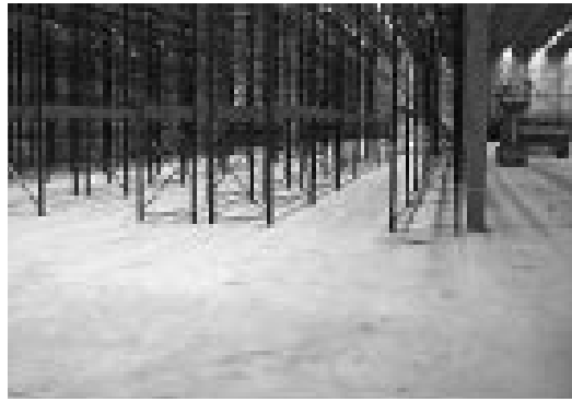
Foto 18: Supervlakke dekvloer in een smalle-gangenmagazijn (foto: Buro Vloeradvies, Nieuwersluis)
