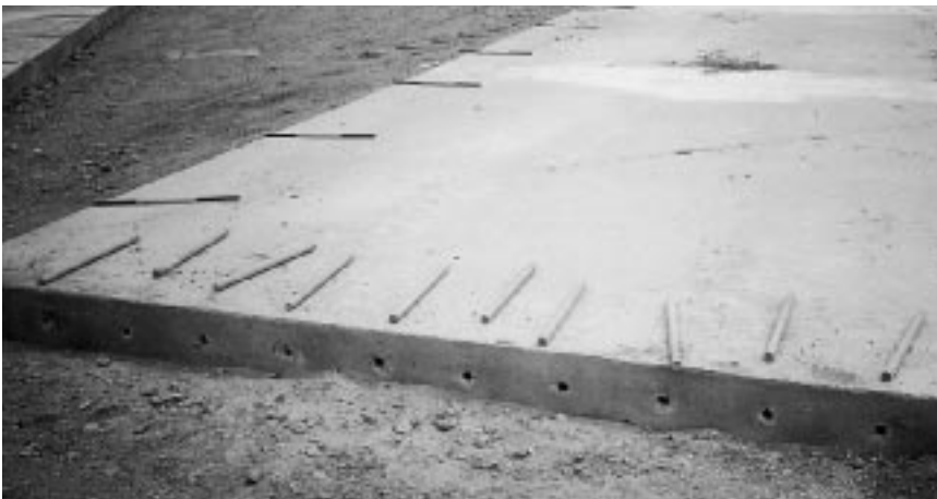
Foto 37: Constructielangsvoeg met koppelstaven in bedrijfsverharding; op de voorgrond een constructie- dwarsvoeg met deuvels
